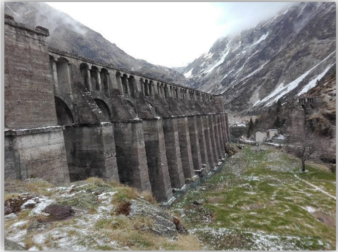
I resti della Diga del Gleno
